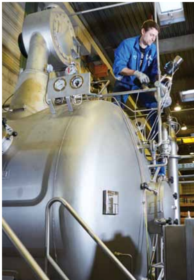
Druckkesselüberprüfung einer Maschine mit THEN-AIRFLOW Technologie. Sie transportiert die Textilien nicht mit der Farblüssigkeit, sondern auf einem Luftkissen durch die Maschine, was z.B. den Wasserverbrauch um 75% und die Prozesszeiten um gut 50% reduziert.
